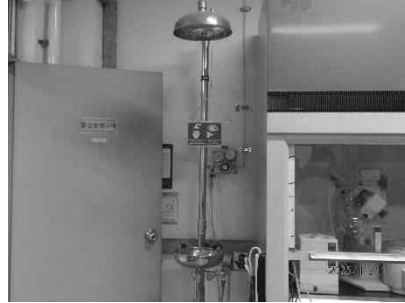
[세안장치 설치 상태]
